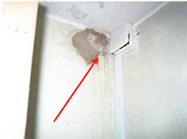
Kuva 5: Liikuntasalin viereisessä projektorihuoneen ylänurkassa, lähellä seinässä kulkevaa syöksytorvea, on vuodon jälkiä
