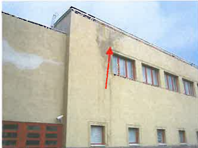
Kuva 1: Kuva Kansankadun puolelta. Rakennuksen julkisivussa on vaurioita ks.syöksytorven kohdalla.
