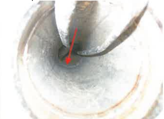
Kuva 4: Syöksytorvi liittyy 0,5 m kohdalla suurempaan syöksytorveen epätiiviviällä liitoksella.
