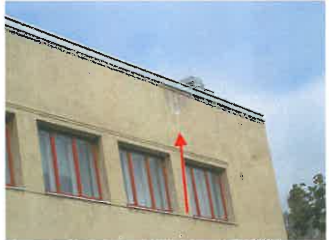
Kuva 2: Rakennuksen Kansankadun puolella lähinnä Saaristonkatua on myös räystäskourun vuodon aiheuttamaa tummumaa rappauspinnassa.
