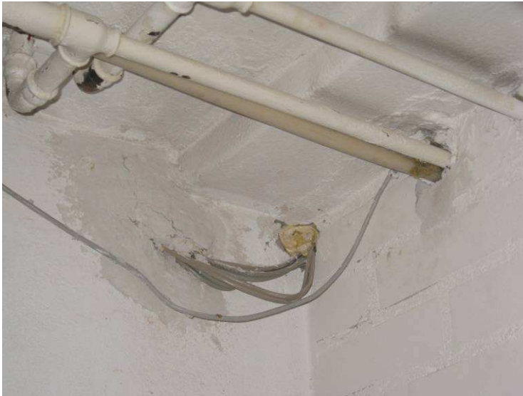
Kuva 3. Johtojen ja putkien heikot tiivistykset.
