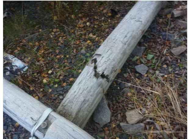
Kuva 4 Telapuissa on vaurioita vesirajassa.
