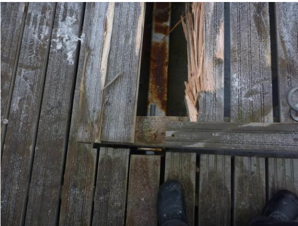
Kuva 9 Lossilaiturin kansilaidoissa on vaurioita.
