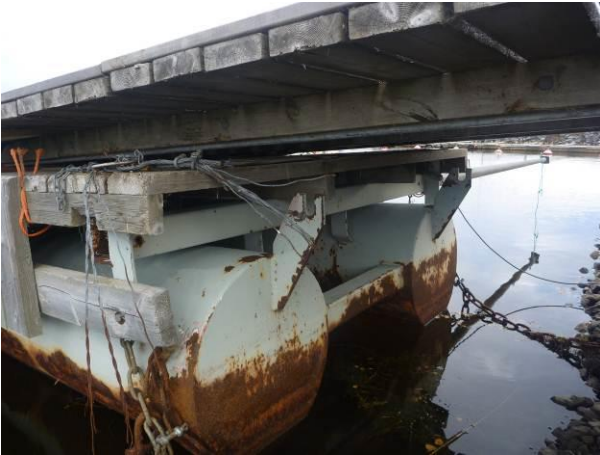
Kuva 7 Teräsponttoonit ovat ruosteessa
