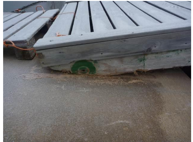
Kuva 5 Kulkusillasta puuttuu rolla.
