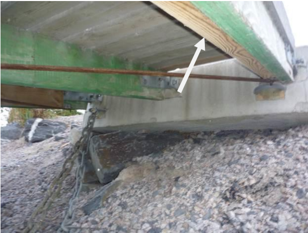
Kuva 1 Vierassataman kulkusillan runkoa on vahvistettu.
