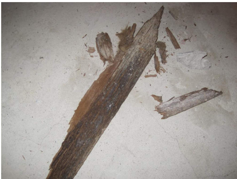
Kuva 2. Kanaalin puumateriaali on lahonnutta ja homevaurioitunutta.
