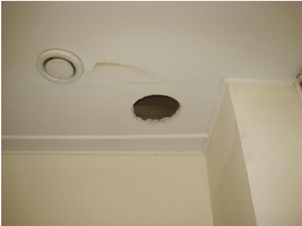
Kuva 4. Ensimmäisen kerroksen naisten vessan katossa oleva rakenneavaus. Kattoverhouslevyssä on kosteusvauriojälkiä.
