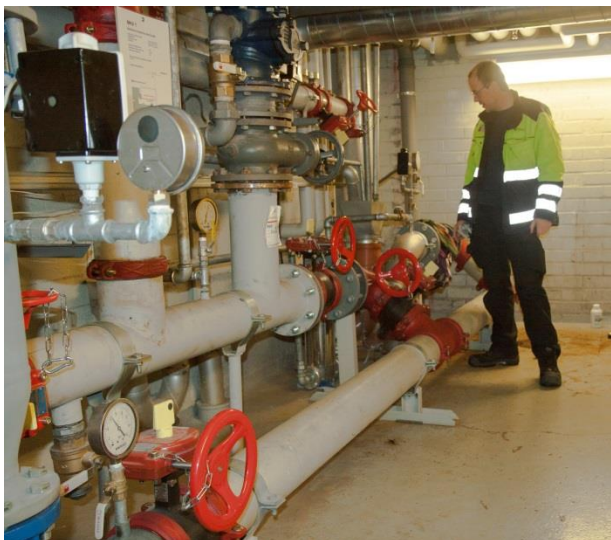
Kiinteistöhoitaja tarkistamassa Oulun kaupunginteatterin sprinklerikeskusta, johon tehdään säännöllisesti toimintakoe huolto-ohjelman mukaisesti.
