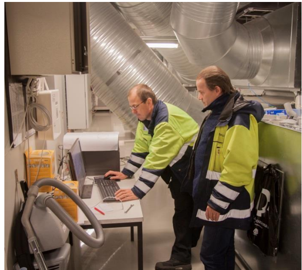
Kiinteistöhoitaja ja kiinteistöyönjohtaja tutkimassa Oulun kaupunginteatterin LVIS- prosessien tilaa teknisessä tilassa. Taustalla yksi kaupunginteatterin kolmestaosta ilmanvaihtokoneesta.
