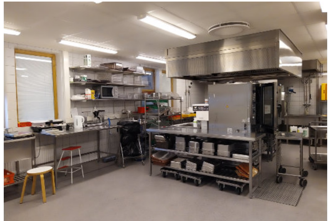
Jakelukeittiössä on mm. 2 uunia, tasoliesi, kylmiö ja astianpalautus ja -pesulinjasto.
