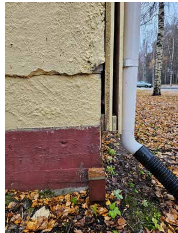
Kuva 55. Rappauksen ja puuverhouksen sauma.
