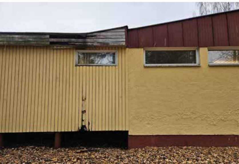
Kuva 53. Katolta valuva vesi on vaurioittanut otsalautaa ja julkisivuverhous.
