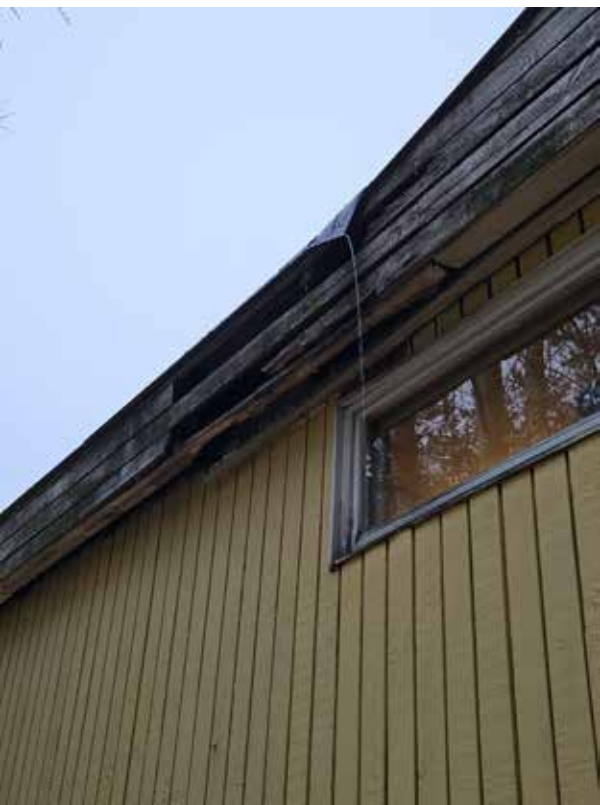
Kuva 45. Viidennen laajennuksen räystäs. Kattovedet ovat vaurioittaneet rakennetta.
