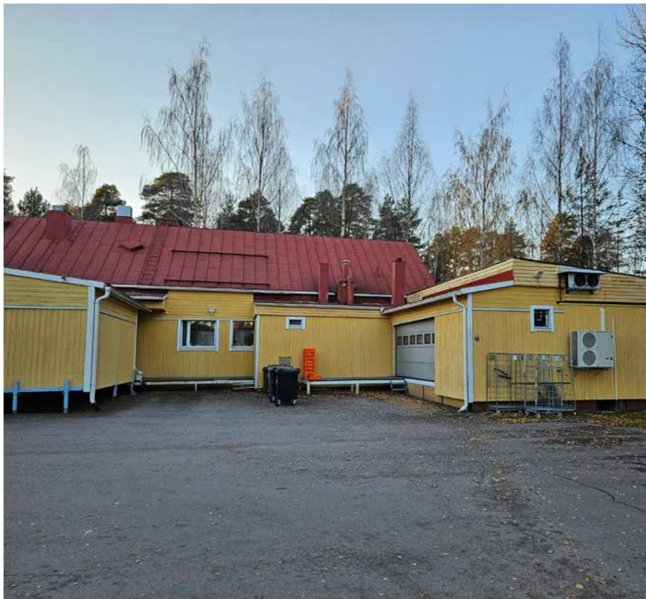
Kuva 50. Sisäpihan lastauslaiturialuetta. Päätyseinällä kylmälaitteiden lauhduttimia.
