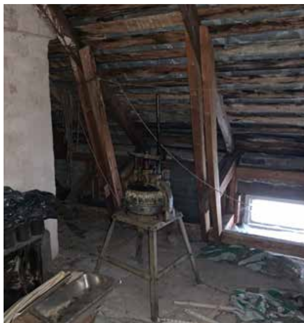
Kuva 89. Ullakkovarastoa ja kosteusvaurioituneita vesikaton ruodelautoja.
