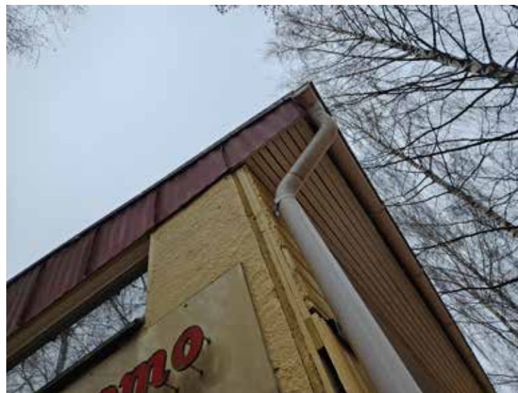
Kuva 46. Pohjoispäädyn sivuräystäään tuuletus on puutteellinen.
