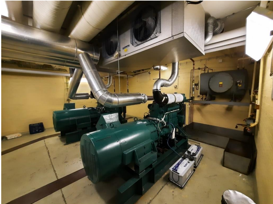
Kuva 78. Varavoimakonehuone ja varavoimakoneet kellarissa.
