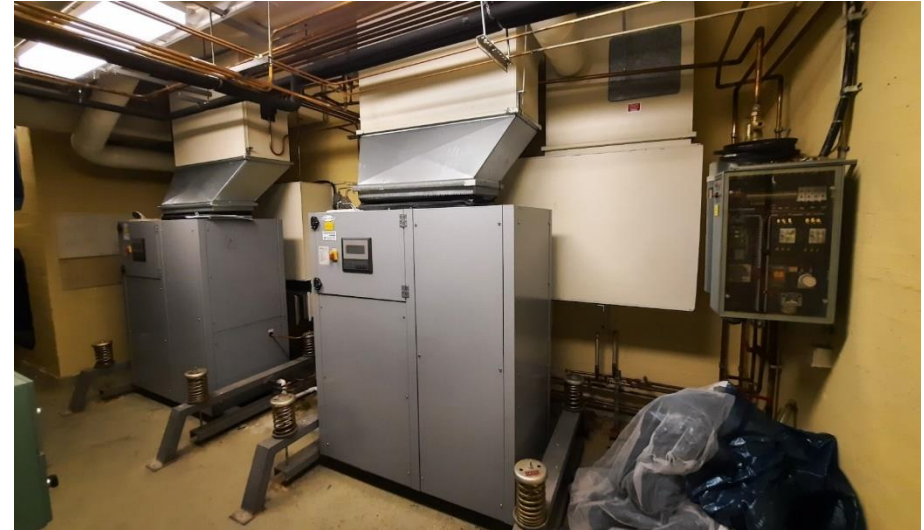
Kuva 79. Kellarin ilmanvaihtohuoneen laitteistoja.
