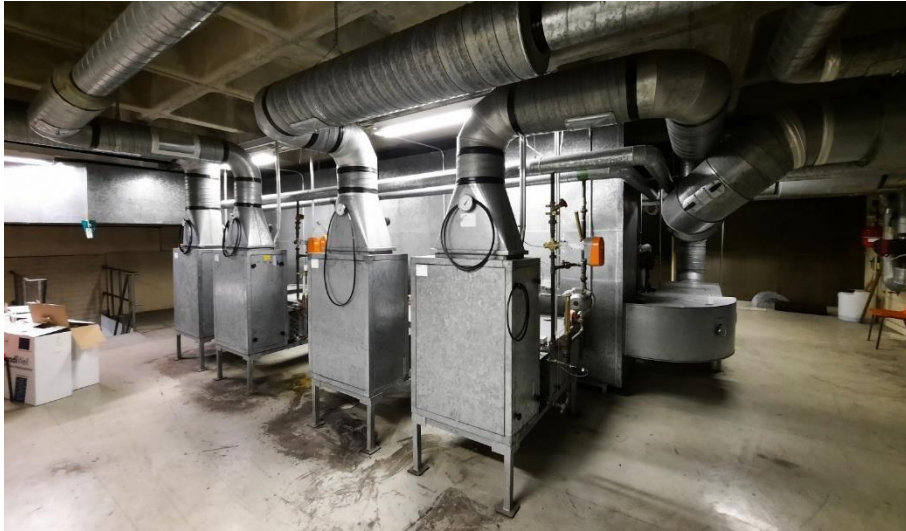
Kuva 81. IV-koneisto toisen kerroksen tuloilmakonehuoneessa.
