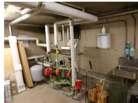
Kellarin kaukolämmön lämmönjakohuone.
