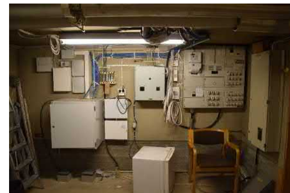
Kellarin lämmönjakohuoneen sähkökeskus.
