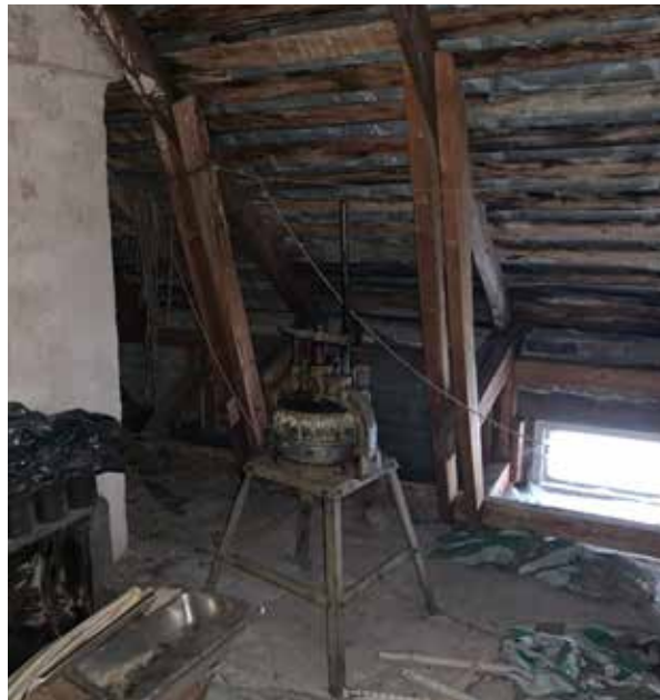
Kuva 89. Ullakkovarastoa ja kosteusvaurioituneita vesikaton ruodelautoja.
