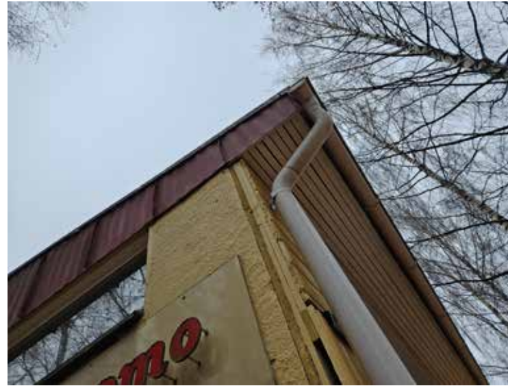
Kuva 46. Pohjoispäädyn sivuräystäään tuuletus on puutteellinen.
