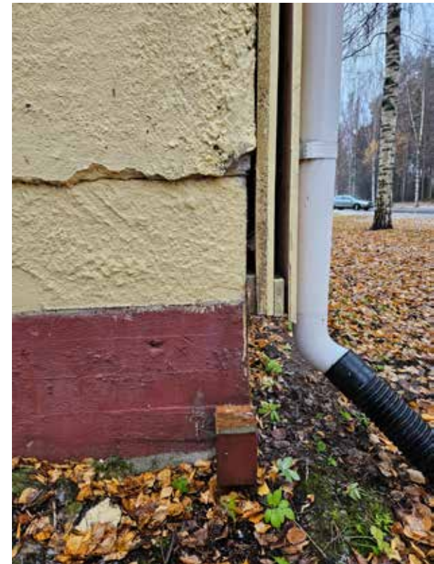
Kuva 55. Rappauksen ja puuverhouksen sauma.
