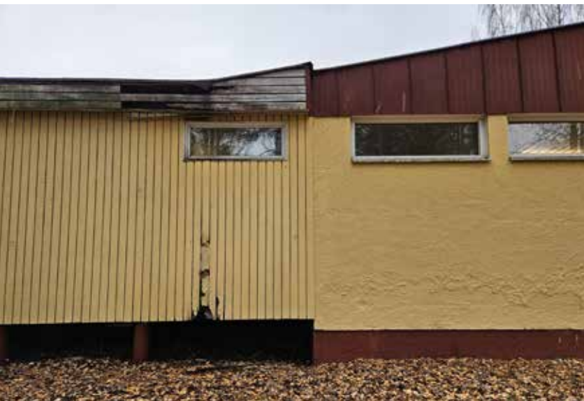
Kuva 53. Katolta valuva vesi on vaurioittanut otsalautaa ja julkisivuverhous.
