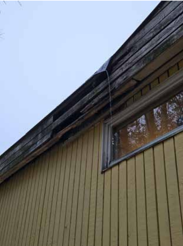
Kuva 45. Viidennen laajennuksen räystääs. Kattovedet ovat vaurioittaneet rakennetta.
