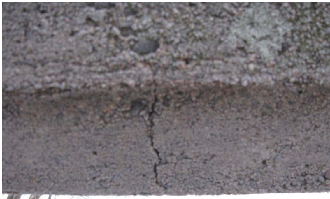
Valokuva sillan kansilaatan alapinnan halkeamasta
