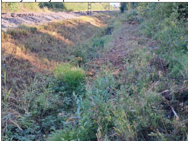
11. Oja kauttaaltaan kuiva (13.8.2025).
