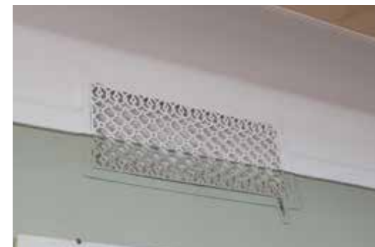
Alla: Käytöstä poistettu 1908 ilmanvaihtorilä.
