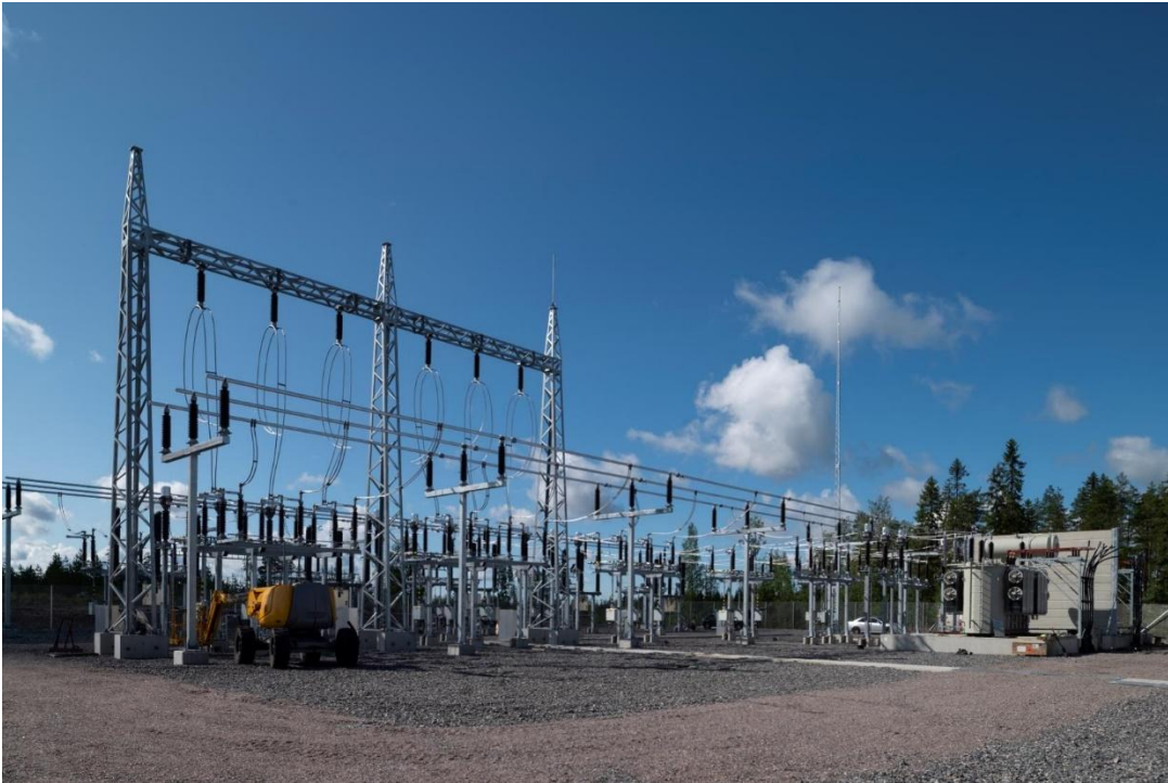
Kuva 5-6. Esimerkki tuulivoimahankkeen sähkösäätämöstä. © Ilmatar Energy Oy.
