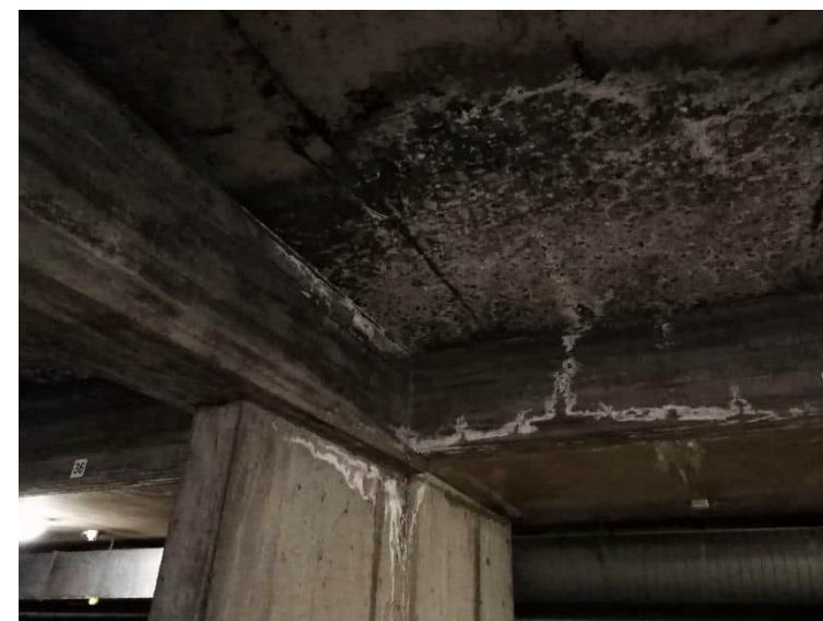
Autohallin rakenteissa on nähtävissä ulkopuolelta sinne valuneen veden jättämät jäljet.
