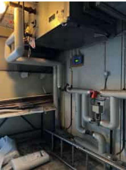
Kuva 111: IV-konehuone. Kuvattu 2022, JK.
