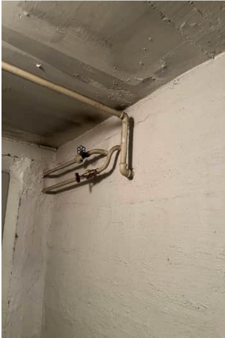
Kuva 9. Kohteen alkuperäisiä vesijohtoputkia.
