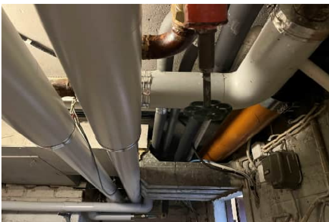
Kuva 6. Lämmönjakohuoneesta lähteviä alkuperäisiä putkistoja.
