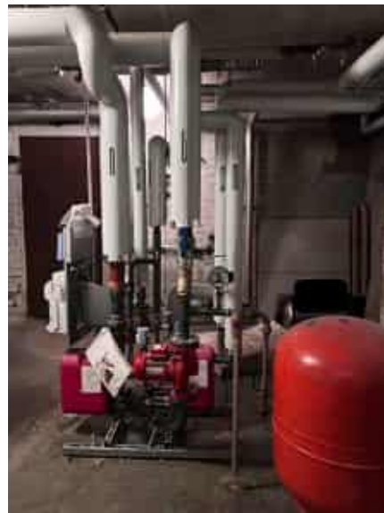
Kuva 113: Lämmönjakohuone. Kuvattu 2022, JK.
