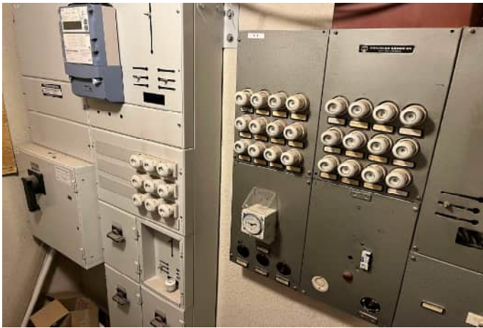
Kuva 16. Uusittu sähkökeskus sekä alkuperäinen sähkökeskus.
