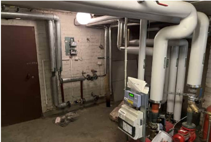
Kuva 5. Uusittu lämmönsiirrin sekä lämmönjakohuoneessa uusitut putkistot.
