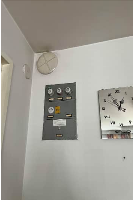
Kuva 13. Huippuimurein varustettu poistoilmaventtiili huoneissa.
