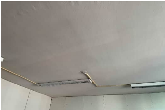
Kuva 14. Alkuperäisiä johdotuksia, uusittuja lamppeja.
