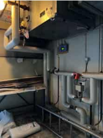
Kuva 111: IV-konehuone. Kuvattu 2022, JK.
