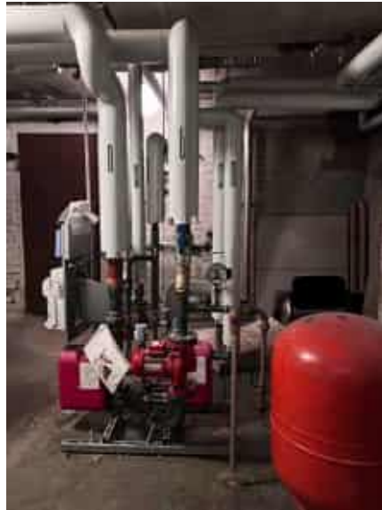
Kuva 113: Lämmönjakohuone. Kuvattu 2022, JK.
