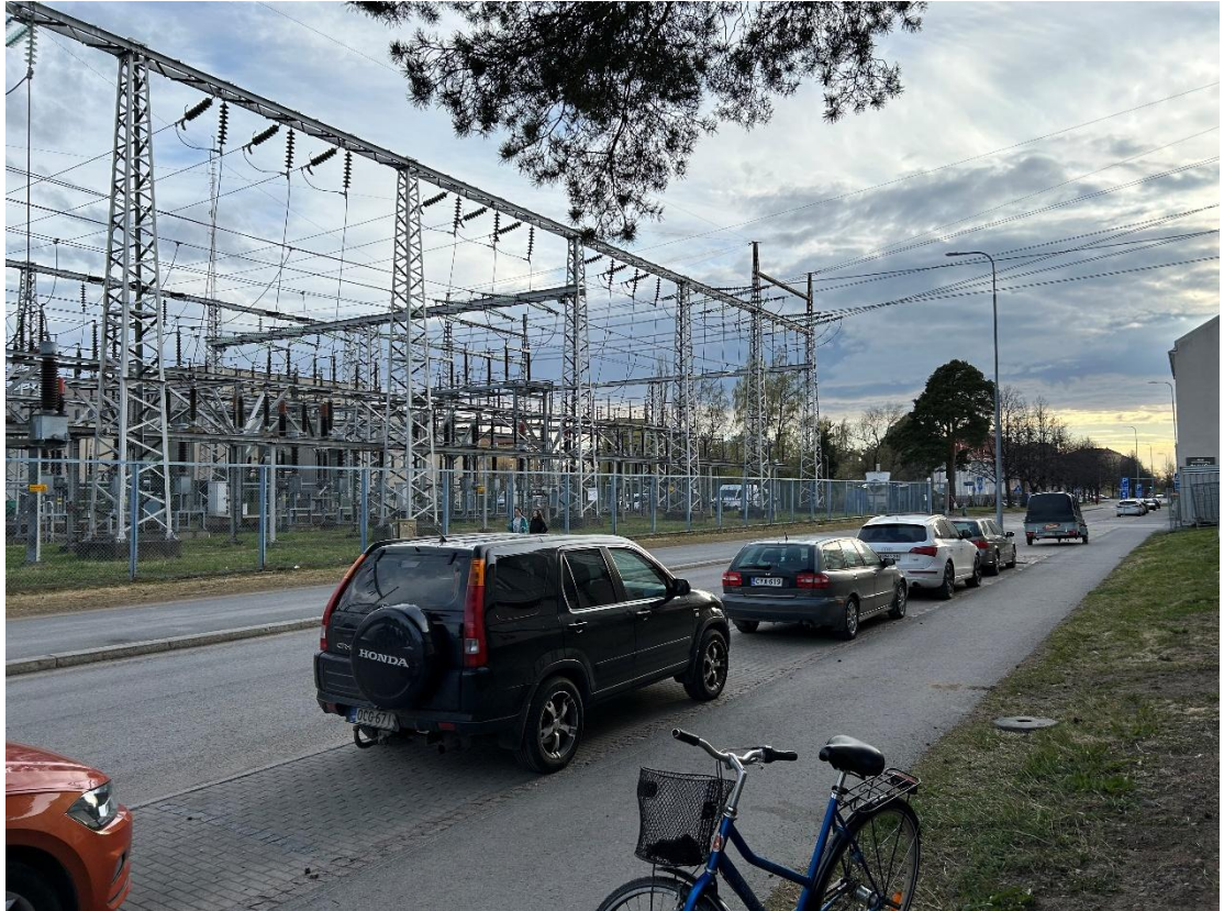
Kuva 8 Kytkenkenttä on suurikokoinen tekninen rakennelma, joka kertoo Merikoskessa tuotettavasta sähköenergiasta. Rakenteen voisi tulkita maisemahäiriöksi, mutta se on toiminnallisesti olennainen osa valtakunnallisesti arvokasta voimalaitosympäristöä.
