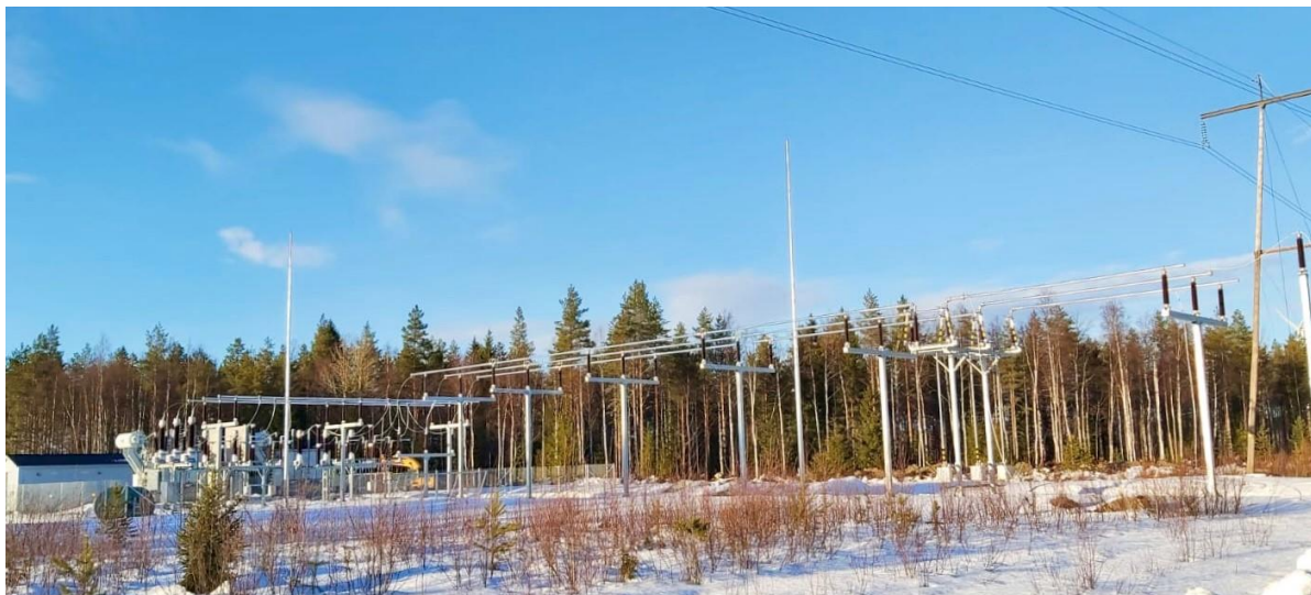
Kuva 2-10. Tuulivoimapuiston sähköasema (© ELTEL Networks Oy).
