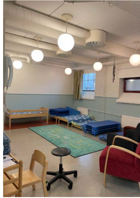
Päiväkotiryhmien huoneissa on vuoden 1998 peruskorjauksessa asennetut pallovalaisimet.
