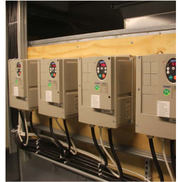
Uusittu automaattiohjaus säätelee rakennuksen sisäilman olosuhteita kuten lämpötiloja, kosteutta ja ilmanlaatua.
