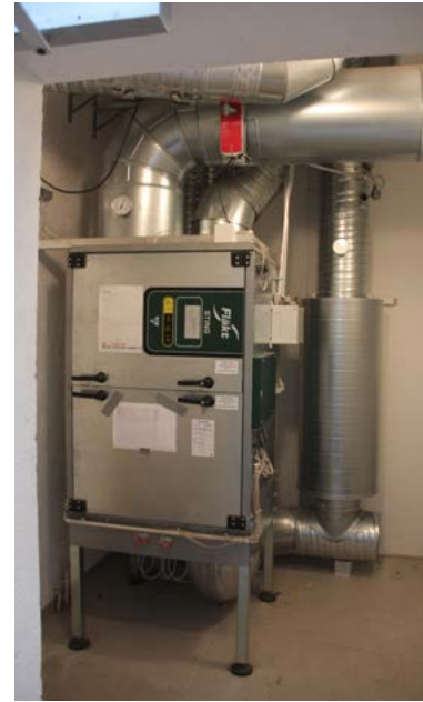
Pienempi ilmanvaihtokone rakennettiin vuonna 2006 entiseen asukasvarastoon.
