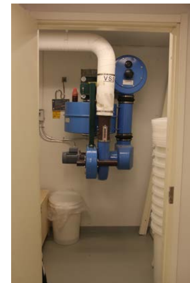
OIKEALLA: Ilmanpuhdistuslaitteet ja käymälä.
