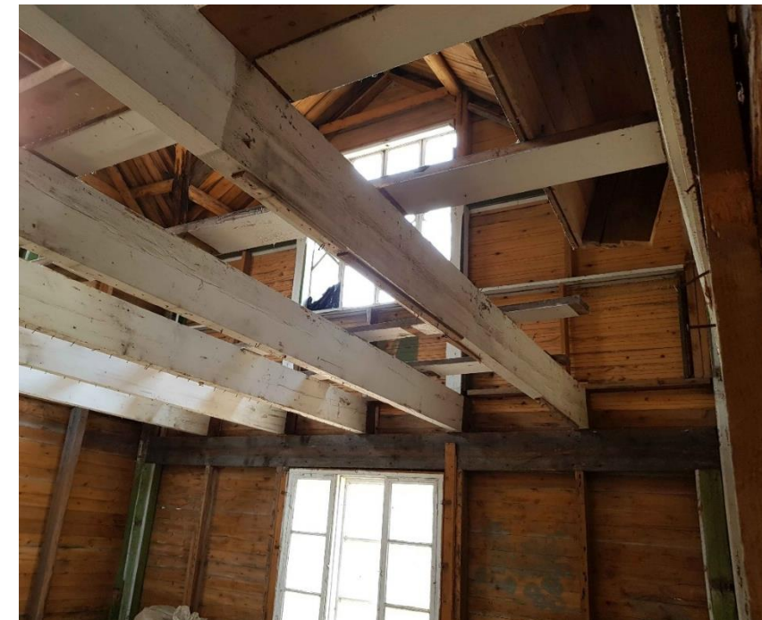
Sisällä eteläjulkisivulla itäpuolen päädyssä näkyy ullakkokerroksen kohdalla uudempaa, taustaltaan uritettua ulkoverhouslautaa.
