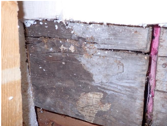
Hirren sisäpinnassa on paikoin tummentumaa, joka voi olla kosteudesta peräisin. Kuva on avauksesta US-RA-7.
