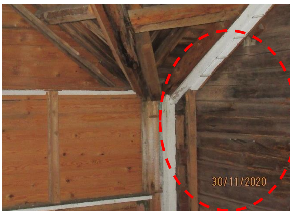
Ulkoseinässä tummentumaa ja viitteitä ylimääräisestä kosteusrasituksesta (2. krs. itäpääty).
