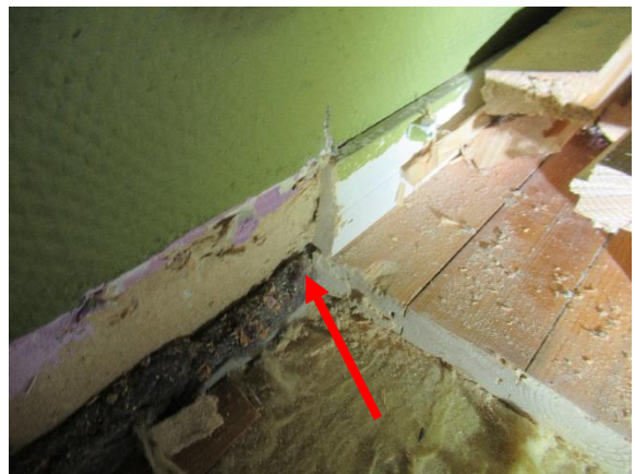
Alapohjan ja väliseinän liittymäkohta ei ole tiivis (AP-RA-1).
