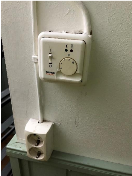
Pesuhuoneen lattialämmityksen termostaatti
