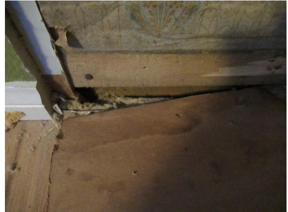
Pahvissa kosteusvauriojälkiä (US-RA-1).
