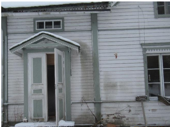
Julkisivuissa kosteusvauriojälkiä ja maalipinnan hilseilyä (pohjoisjulkisivu)
