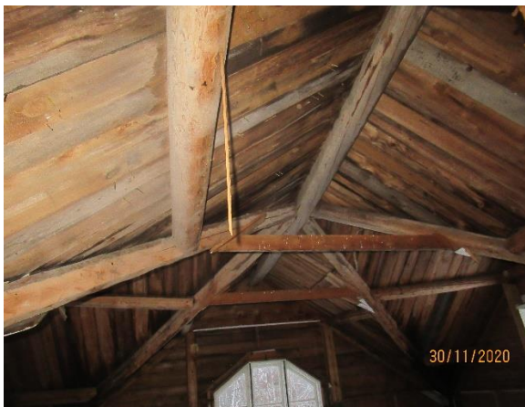
Rakennuksen itäpuolen kattorakenteissa katto- vuotoja sekä mikrobi-, kosteus- ja lahovaurioita.
