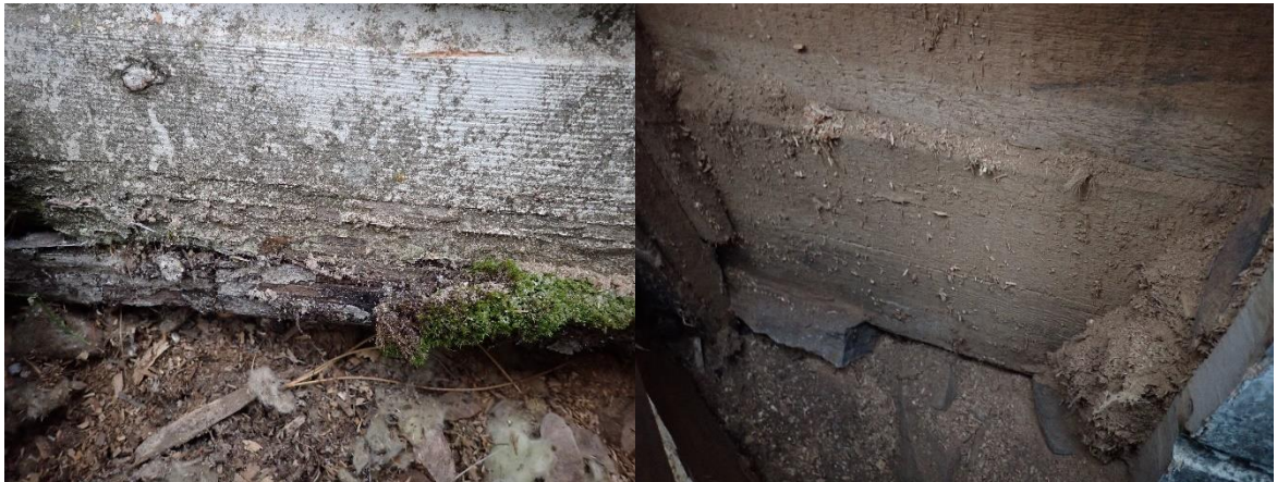
Ulkoverhouslauta on lahovaurioitunut. Kuva on avauksesta US-RA-2 ulk.
