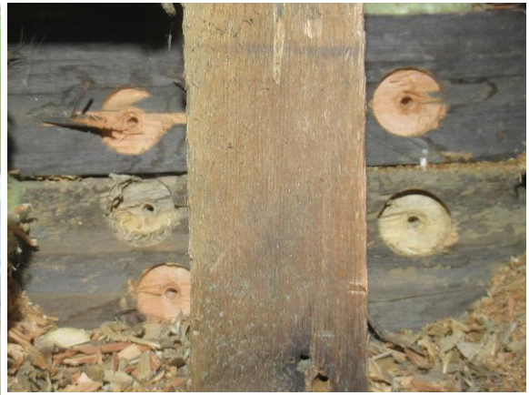
Sisemmän vaakapaneelin ulkopinnan lahoporausten perusteella paneeli värimuutos on paikoin pintaa syvemmällä (US-RA-4)
