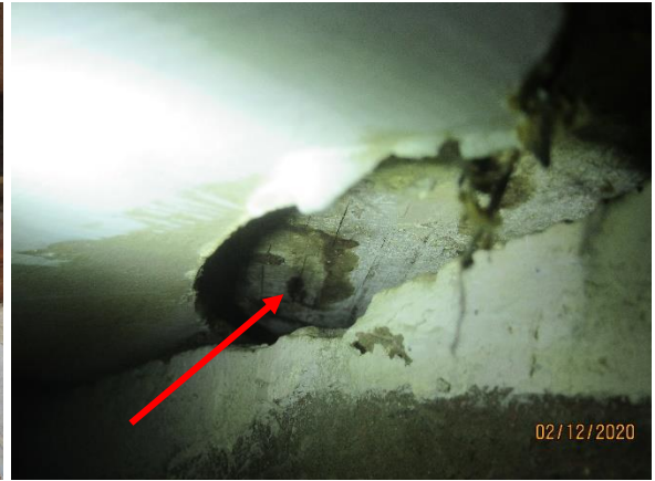
Salin hormiläpiviennin ympärillä on viitteitä kosteusvaurioista myös huonetilan puolella.
