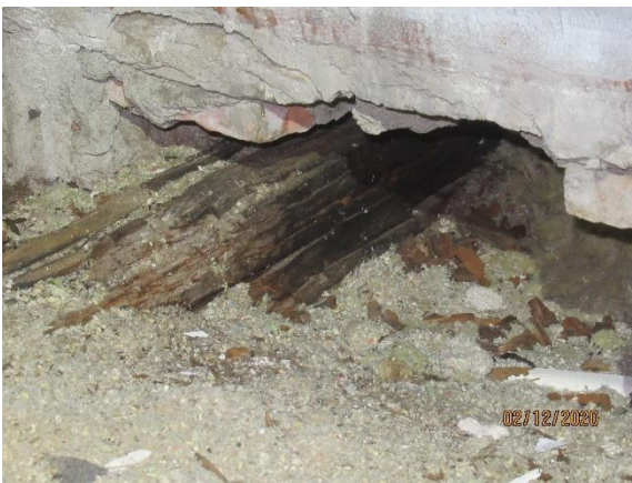
Kantavassa puupalkissa lahovaurioita salin tulisijan hormin kohdalla (YP-RA-2 vieressä).
