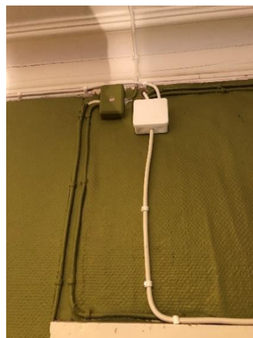
Olohuoneen valaistuskaapeli on vanhempaa (kuvassa vihreä maalattu kaapeli)
