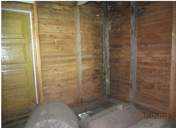
Ulkoseinänurkkauksessa mikrobi-, kosteus- ja lahovaurioita (1. krs. itäpääty).
