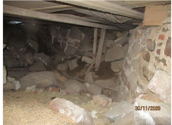
Tuuletustilan maapohjan päällä sahanpurua ja rakennusjätettä.
