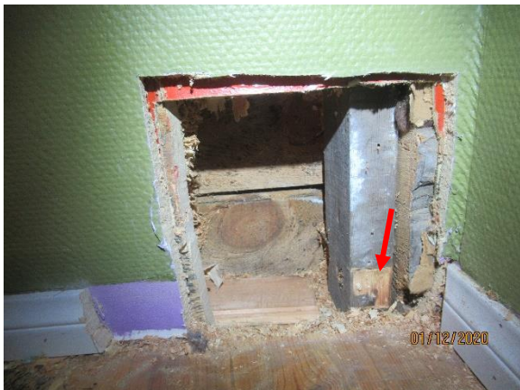
Runkotolpan pinnat harmaantuneet. Runko- puussa näkyvä valkoinen väri on maalia. Runko- puusta otettu näytteenotto kohta osoitettu nuo- lolla (US-RA-5)
