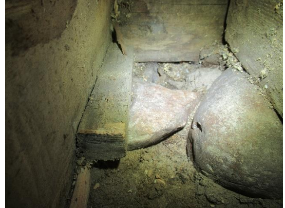
Alapohjan kannattajapuu on suoraan perustuksina olevien luonnonkivien päällä, puuosat ovat myös paikoin kosketuksissa maahan (AP-RA-1).
