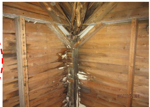
Ulkoseinänurkkauksessa mikrobi-, kosteus- ja lahovaurioita sekä lahottajasientä (2. krs. itäpääty).
