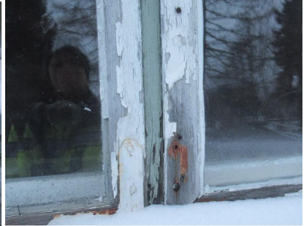
Ikkunapuitteet lahonneet (rakenneaukaisun US-RA-5 vieressä oleva ikkuna)
