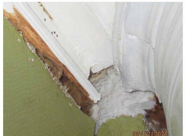
Salin hormiläpiviennin ympärillä viitteitä lahovaurioista myös huonetilan puolella.
