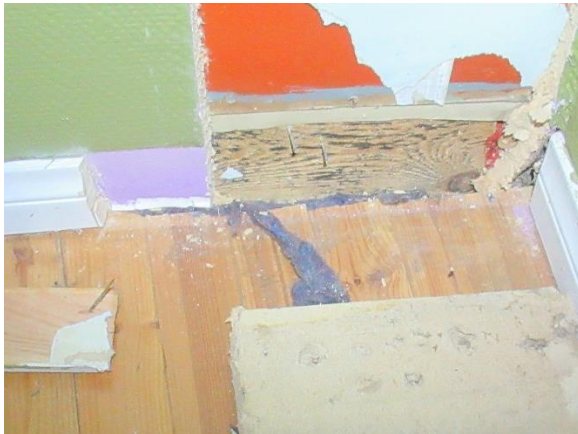
Sisustuslevyn ulkopinnassa tummentumaa ja mikrobikasvuviitettä (US-RA-5)
