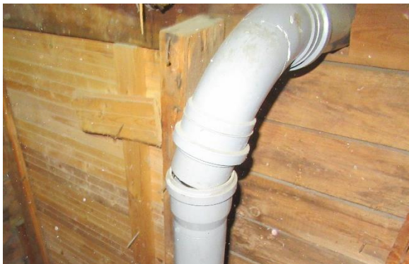
Liitoksesta auennut viemärin tuuletusputki pesuhuoneen kohdalla yläpohjassa.
