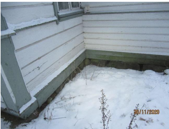
Ryömintätilan tuuletus tapahtuu perustuskivien välisistä raoista.
