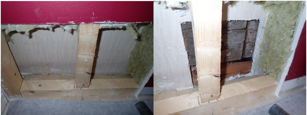
Lisälämmöneristys on toteutettu villaeristeellä. Villaeristeen ja hirsirungon välissä on EPS-eristelevy, jonka sisäpinnassa on tapetti.
