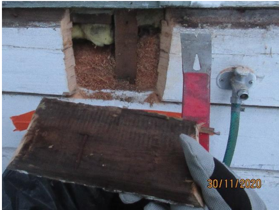
Ulkoverhouspaneelin sisäpinnassa tummentumaa (US-RA-4)
