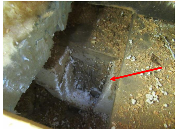
Rakennevauksesta (AP-RA-2) havaittiin hirsirunkoa vasten olevan EPS-levy.
