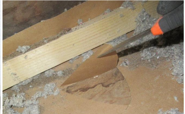
Yläpohjan rakenneavauksessa YP-RA-2 havaittiin kattopaneelin pinnassa kosteusjälkiä.
