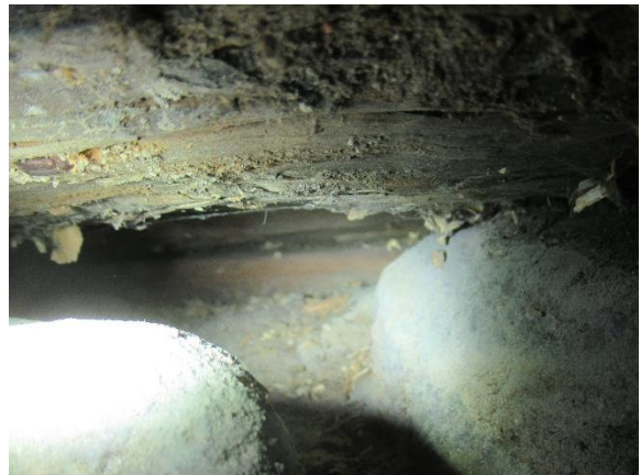
Länsipuolen salin ja itäpuolen eteisen välinen kantava alaosassa lahovauriota.
