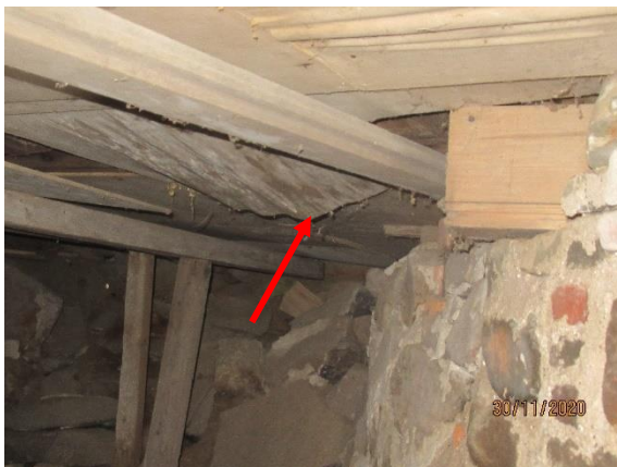
Alapohjarakenteen alaosassa kiinnityksistä irronneita ja kupruilleita/kosteusvaurioituneita levyrakenteita.
