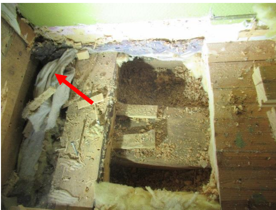
Alapohjan ja ulkoseinän liittymäkohta ei ole tiivis, reuna-alueilla eristeinä kangasmateriaaleja. (AP-RA-1).
