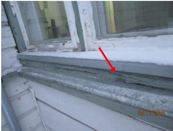
Ikkunoita ympäröivissä puurakenteissa lahovaurioita US-RA-4 kohdalla.
