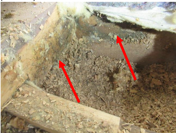
Alapohjan koolauspuussa ja väliseinän alimmaisessa hirressä havaittiin kosteus- ja mikrobivauriojälkiä (AP-RA-1).
