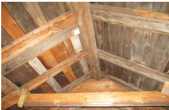
Yläpohjassa ei havaittu harjatuuletusta (rakennuksen länsipääty).
