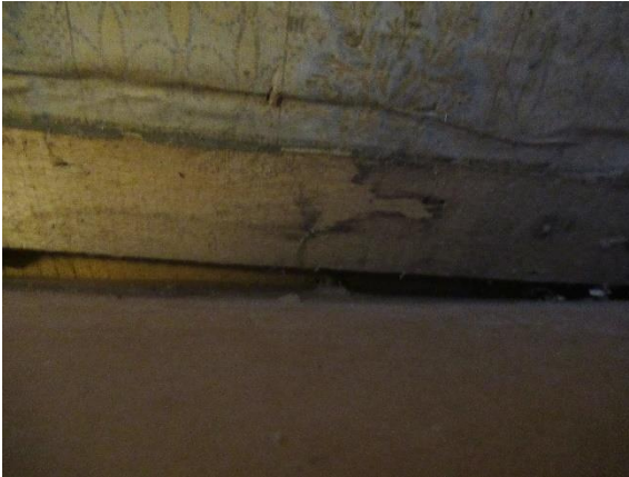
Vaakakoolauksessa kosteusvauriojälkiä (US-RA-1).
