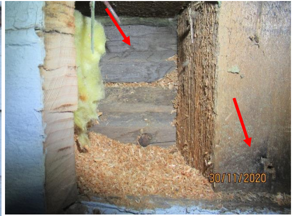
Sisemmän paneelin ulkopinnassa ja runkotolpan ulkopinnassa tummentumaa ja viitteitä kosteusrasituksesta (US-RA-4)
