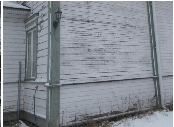
Julkisivuissa kosteusvauriojälkiä ja maalipinnan hilseilyä (rakennuksen lounaisnurkka)
