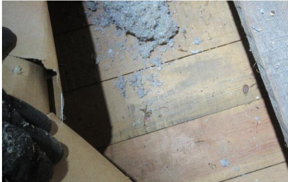
Yläpohjan rakenneavauksessa YP-RA-1 havaittiin kattopaneelin pinnassa mikrobivaurioon viittaavaa värjäytymää.
