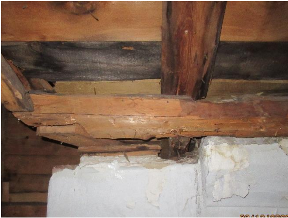
Rakennuksen länsipuolen kattorakenteissa on kosteusvaurioita ja viitteitä mikrobivaurioista salin tulisijan hormin kohdalla (YP-RA-2 vieressä).
