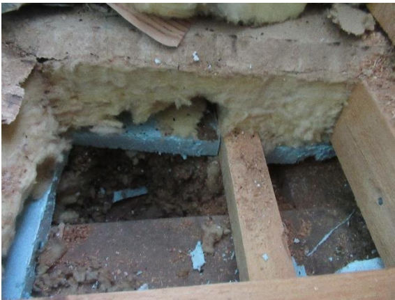
Rakennevauksen (AP-RA-2) kohdalla alapohjan eristeenä on mineraalivilla, alla XPS-eriste ja mineraalivilla täyttöhiekkaa vasten.
