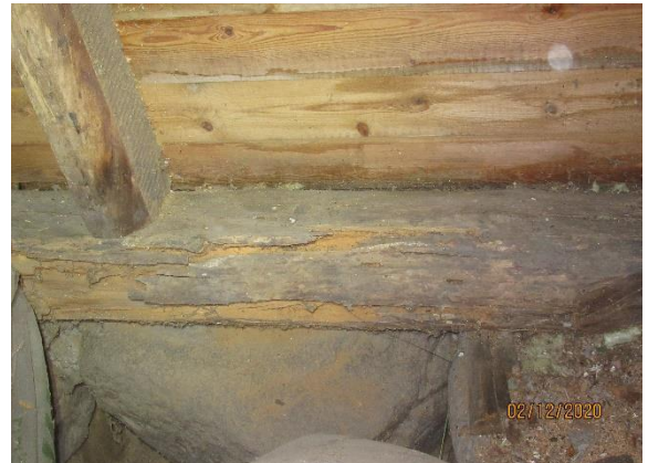
Ulkoseinässä lahovaurioita (1. krs. itäpääty).
