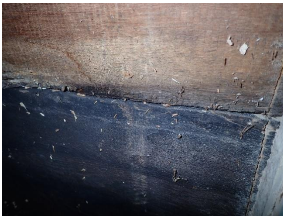
Sisäpuolisen vaakapaneelin sisäpinnassa tummentumaa ja viitteitä kosteusrasituksesta (US-RA-3).
