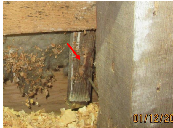
Lisälämpöeristyksen koolausrimassa tummentu- maa ja viitteitä kosteusrasituksesta (US-RA-5)
