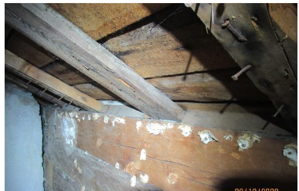
Yläpohjassa ei havaittu räystästuuletusta (salin yläpuolelta).
