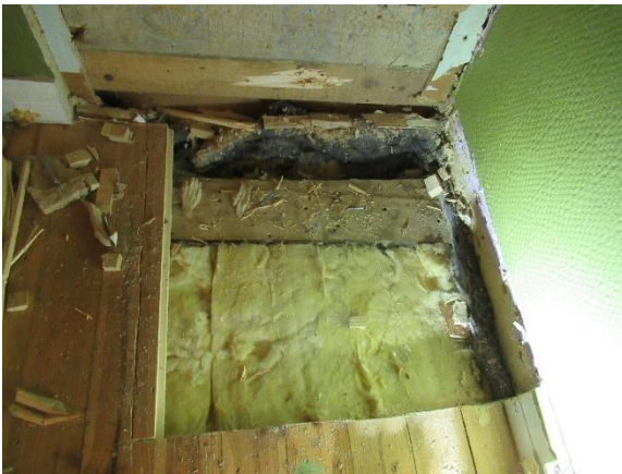
Ulkoseinän ja alapohjan liittymäkohta on epätiivis (US-RA-1).
