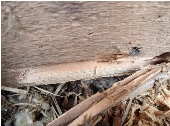
Hirren alaosassa ulkoreunalla on lahovaurioita noin 60 mm korkeuteen.
