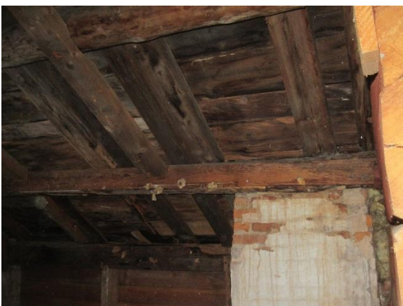
Kattorakenteissa ja keittiön tulisijan tiilihormissa havaittiin vesi- ja mikrobijälkiä.
