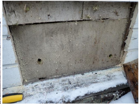
Tuulensuojalevyn lasikuituverkossa on paikoin tummentumaa, joka voi olla kosteuden aiheuttamaa. Kuva on avauksesta US-RA-8.
