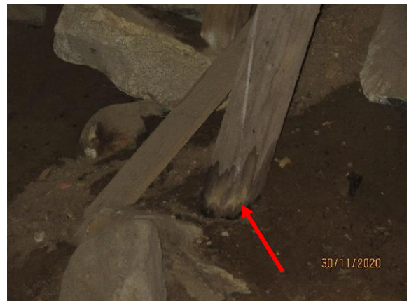
Alapohjarakenteen tukirakenne maata vasten, puutolpan alaosassa kosteusvauriojälkiä.
