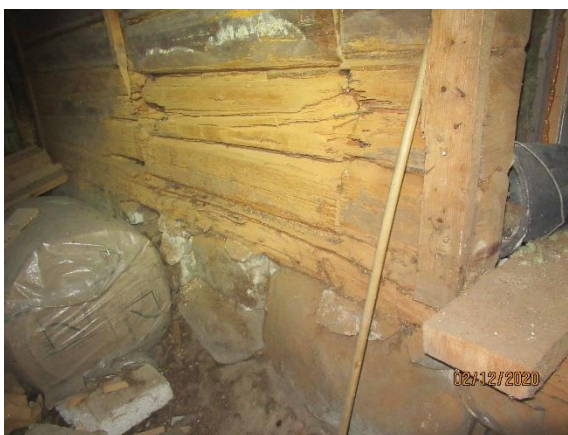
Lahovaurioita itäpäädyssä olevan huoneen ja kamarin välisessä väliseinässä (itäpäädyn huoneen puolelta).
