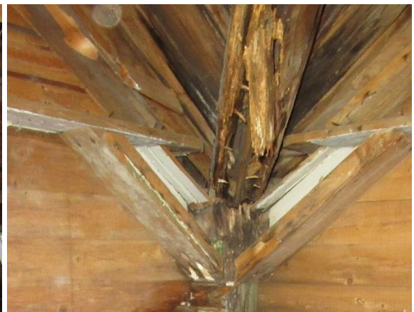
Rakennuksen itäpuolen kattorakenteissa katto- vuotoja sekä mikrobi-, kosteus- ja lahovaurioita.
