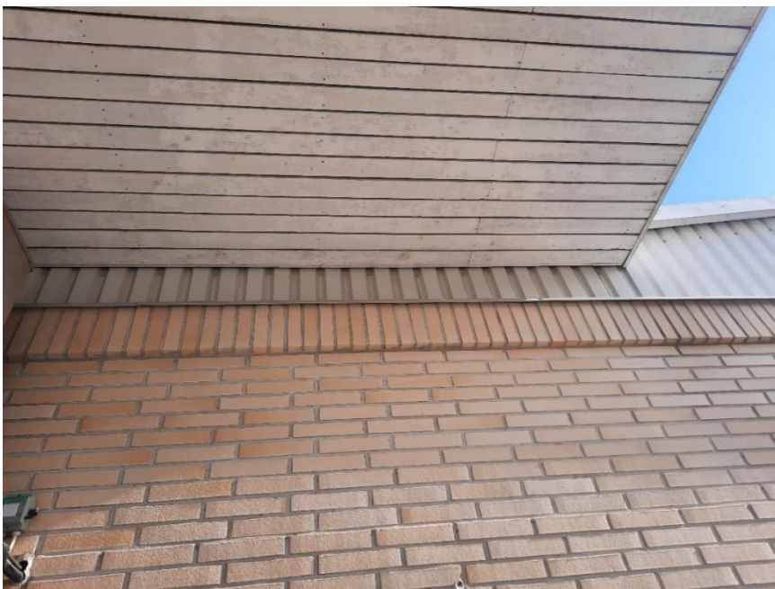
Kuva 14. Osassa tiiliverhoiltuja rakennuksia on lepakonmentäviä rakoja, mutta yläkattorakenteet ovat hyvin matalat, eikä ne sovellu kovinkaan hyvin lepakoille.
