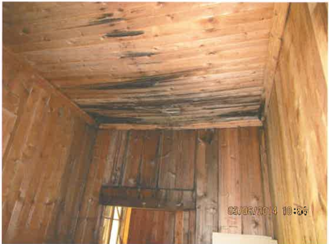
Valokuva 5. Alakatossa on havaittavissa merkkejä kosteuden kertymisestä yläpohjan ja tornin seinän liitoskohtaan.
