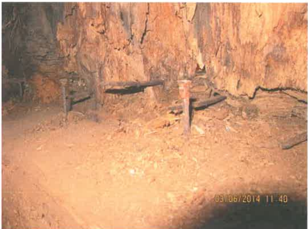
Valokuva 2: Nurkan alueen pystyohirret olivat lahonneet alaosistaan poikki. Alajuoksuohirren yläpinta oli seinän kohdalla lahonnut.
