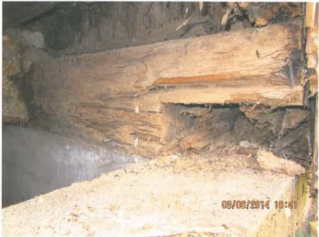
Valokuva 1: Kuva tornin väliseinän ja ulkoseinän nurkasta. Alajuoksuohirret ovat nurkan kohdalla pahoin lahonneet.
