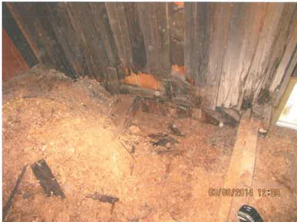
Valokuva 4. Tornin ja yläpohjan liitoksen puurakenteet olivat pahoin vaurioituneet.
