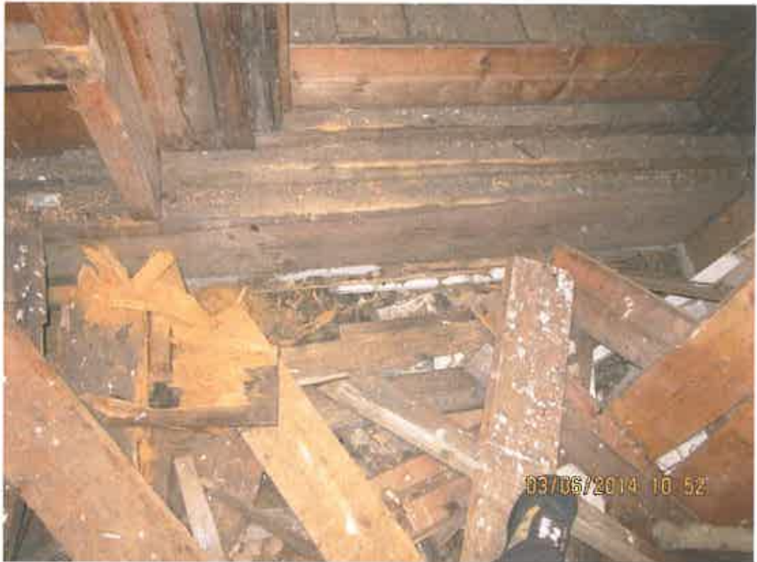
Valokuva 3. Kuva tornin sisältä, oviaukon kohdalta. Puurakenteissa on havaittavissa kastumisen jälkiä.
